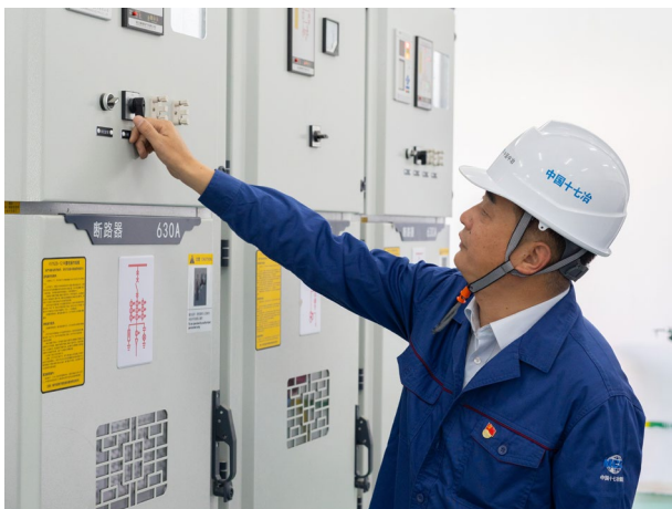
▲ 李跃宁在检查马鞍山博望区人民医院项目配电室电气设备
